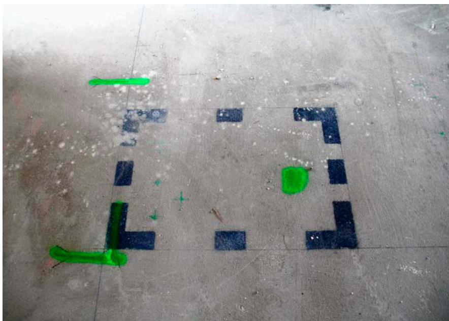
“De standaardisatie van de leidingkoker is voor de installateur ook gemakkelijker. Hij hoeft bijvoorbeeld maar één gat te boren.”
